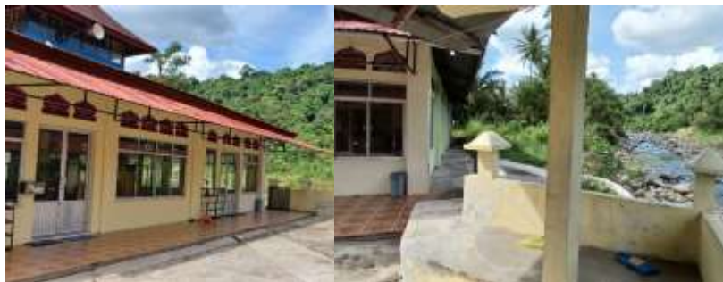
Gambar 3. Foto musholah batu busuk yang sudah berada di pinggir sungai akibat jalur aliran sungai yang telah berubah
